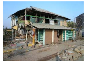
強風と高潮で破壊されたホテル
