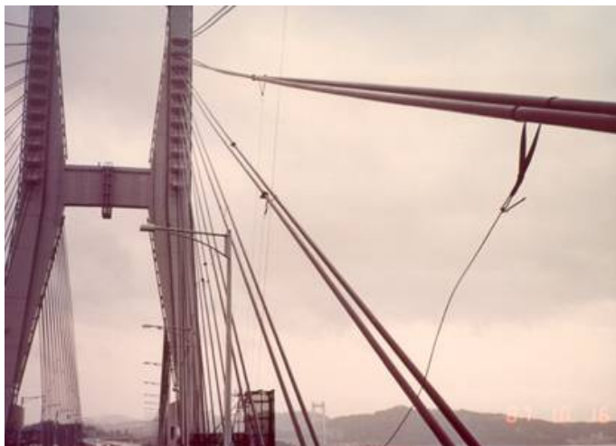
図 1.2 風で振動する斜張橋ケーブル
